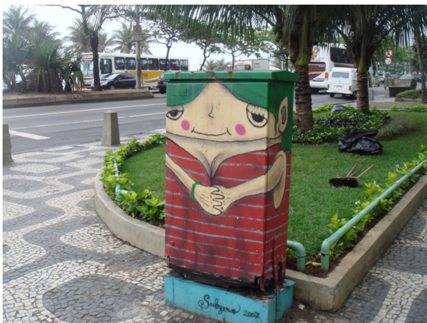
Figura 12: O grafite “trata” as instalações elétricas de sinais de trânsito em toda a cidade. Estes elementos, assim como alguns muros - públicos ou privados, parecem ter tido seu uso como suporte para intervenções artísticas, estimulado pelas últimas administrações municipais. (Av. Delfim Moreira, próximo à rua General Urquiza)
